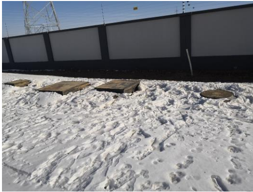
地埋式一体化污水处理设施
