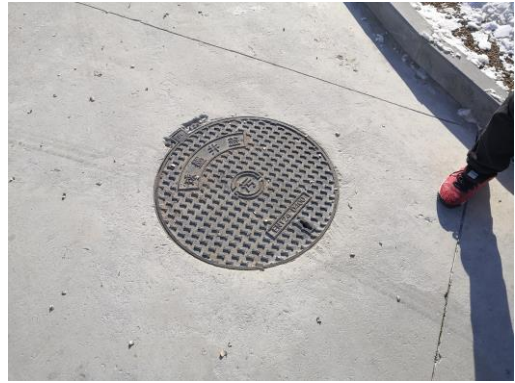
升压站内污水管网
