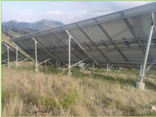
光伏发电区监测
