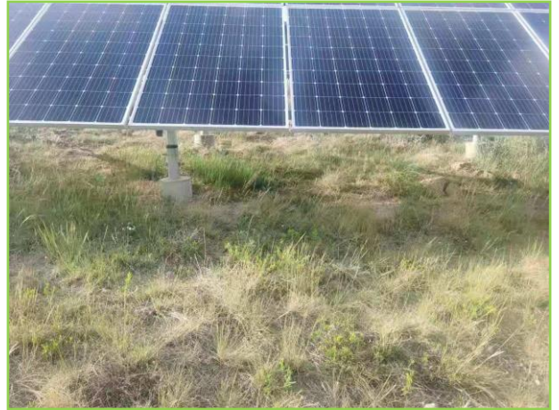
光伏发电区监测
