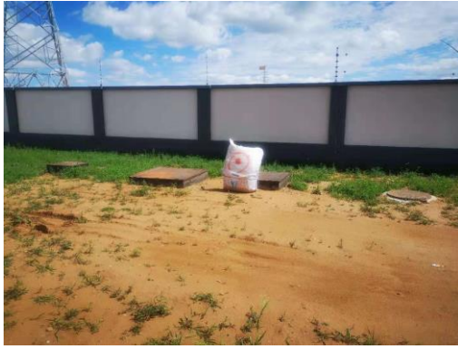
地理式一体化污水处理设施
