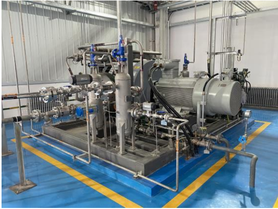
设备底部的基础减震且位于室内
