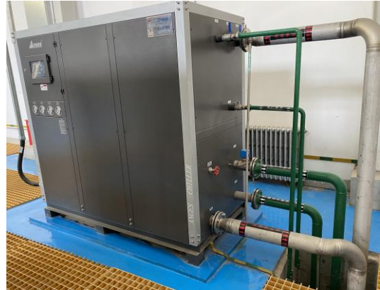
设备底部安装有减震且位于室内
